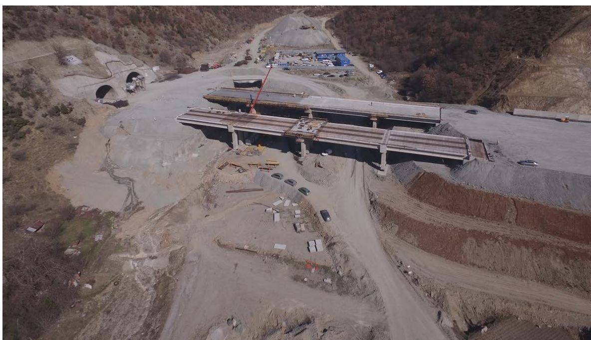
Снимка № 9. Напредък на строителните дейности в подучастък 2 – изграждане на моста след южната част на тунела
